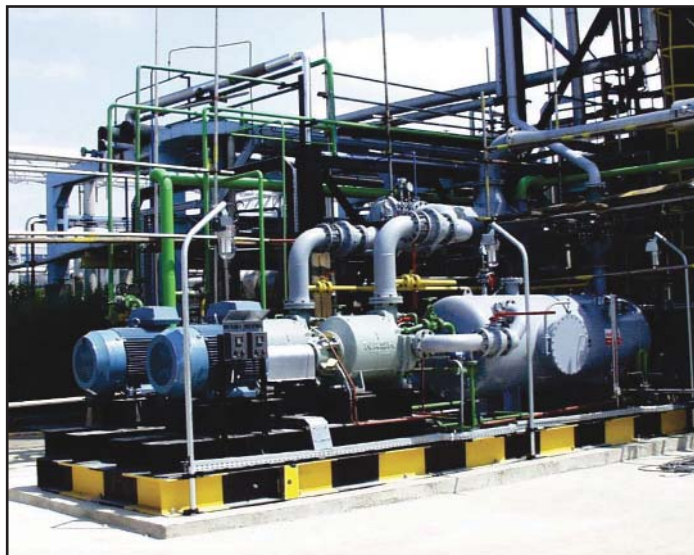
Дуплексная вакуумная система в ректификационной колонне для сырой нефти
